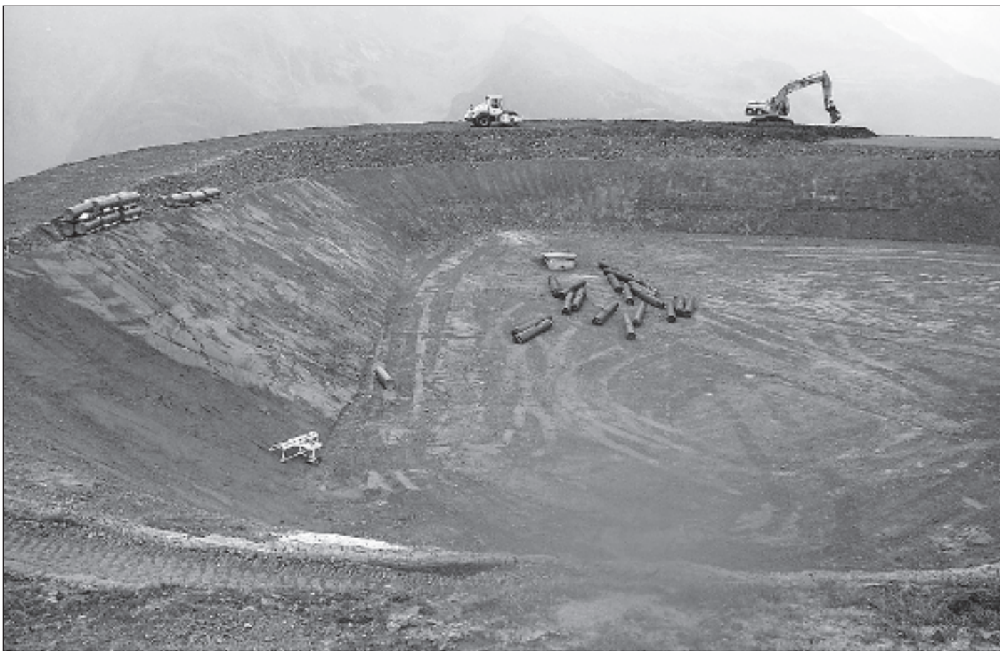
Das Becken des Speichersees ist bereit. Eine Folie wird den Seegrund absolut wasserdicht machen.
